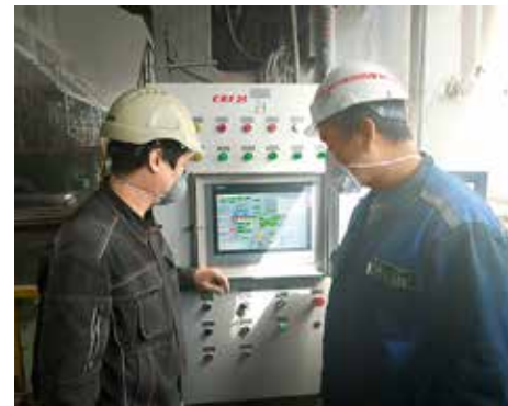
Дробилки оснащены современными системами управления
